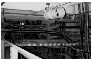
Фото 6 АГС-7/2 в кабельному каналі
